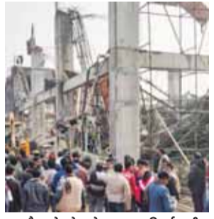
कन्नौज रेलवे स्टेशन पर निर्माणाधीन इमारत गिरने के बाद भारी ढांचा अतिक्रान्त। पीएनएस। लखनऊ/कन्नौज
