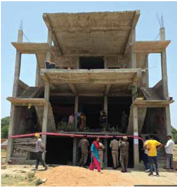
चारों निर्माण जिस क्षेत्र में किये जा रहे हैं, वह क्षेत्र अंसल एपीआई हाईटेक टाउनशिप में आता है। अंसल एपीआई के सक्षम अधिकारियों से जवाब.तलब किया गया तो पता चला कि उक्त सभी निर्माण कार्य निजी बिल्डरों द्वारा अवैध रूप से किये जा रहे हैं। अंसल द्वारा न तो उन लोगों को जमीन बेची गयी है
